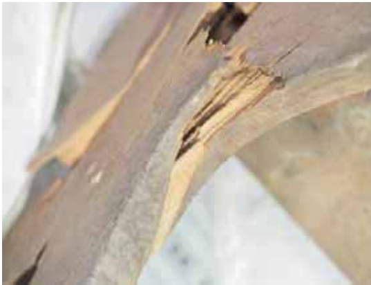
그림 5. 우측하단 권두형 봉 파손상태
