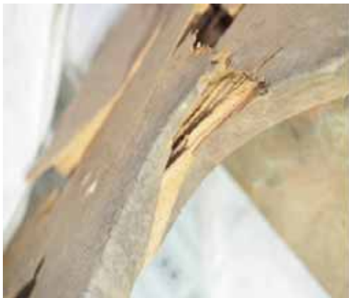
그림 5. 우측하단 권두형 봉 파손상태
